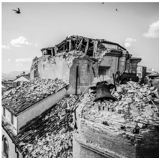
Figura 2-6 Conseguenze di un sisma su un edificio in muratura
