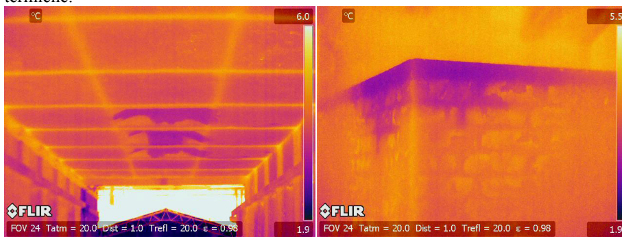
Fig 11 – Termogrammi eseguiti nel periodo invernale nella cartiera di Ceprano. È evidente la maglia strutturale sotto intonaco come anche l'apparecchio murario e un ponte termico dovuto ad infiltrazioni d'acqua.
