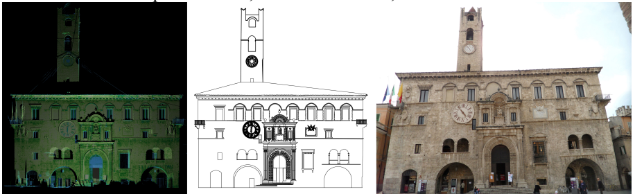
Fig 1 – Visualizzazione della nuvola di punti in BiGrGBrOr map per mezzo della quale si evidenziano in verde gli effetti di dilavamento al di sotto di mensole e marcapiani. Restituzione 2D e immagine della facciata.
