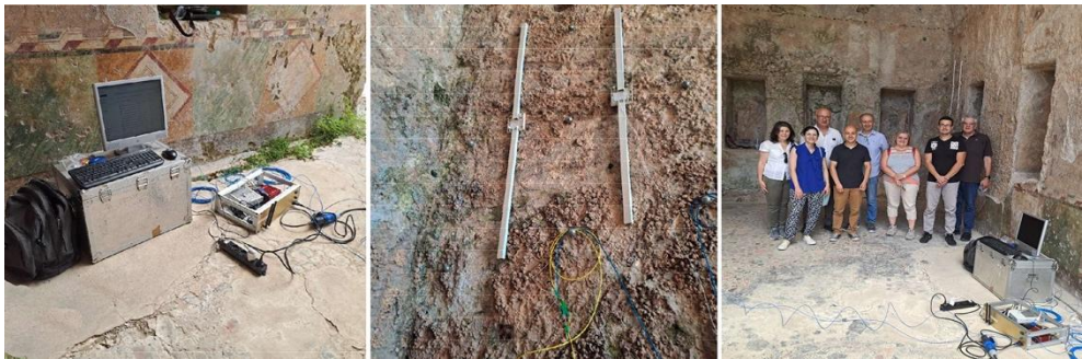
Figura 22 – Strumentazione e crackmetri (© ENEA Research Centre di Frascati) per il monitoraggio strutturale da remoto. Il gruppo di ricerca.
