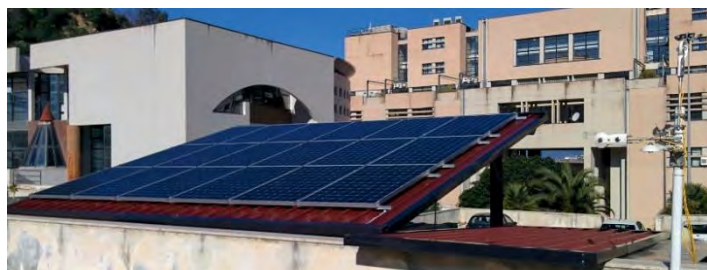
a) pannelli fotovoltaici
