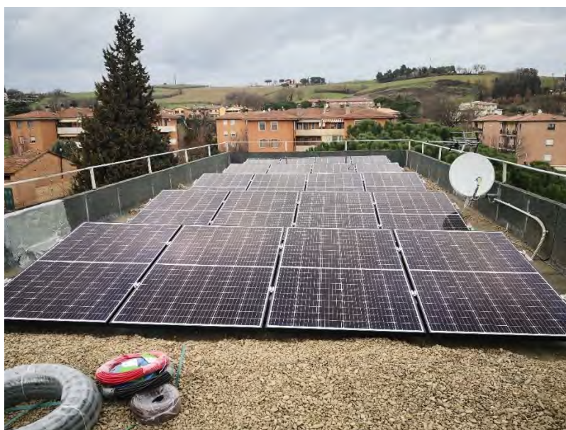
Figura 8: Impianto fotovoltaico installato (vista 1)
