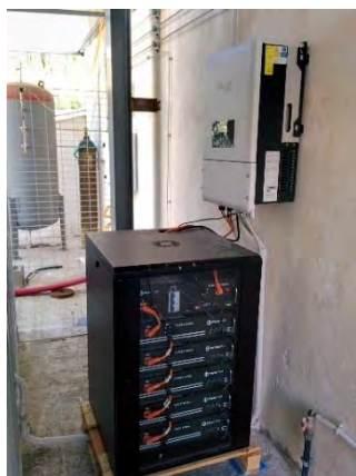
b) inverter e batterie di accumulo
