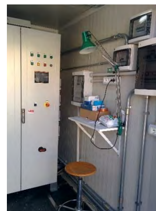
h) PLC – pannello di controllo
