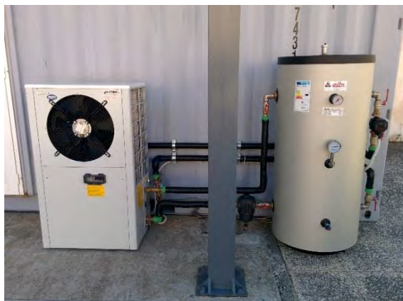
e) chiller e accumulo acqua tecnica
