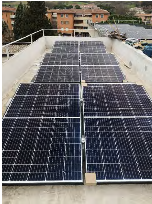
Figura 9. Impianto fotovoltaico installato (vista 2)
