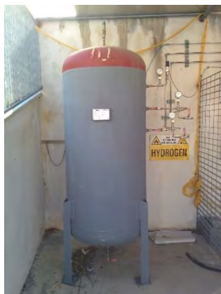
d) serbatoio di accumulo idrogeno
